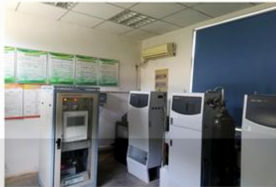
废水处理站北区废水在线监控设施
