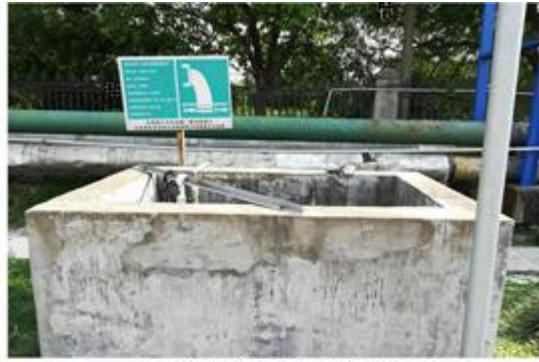
废水处理站北区标准化排放口
