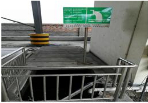
废水处理站南区标准化排放口
