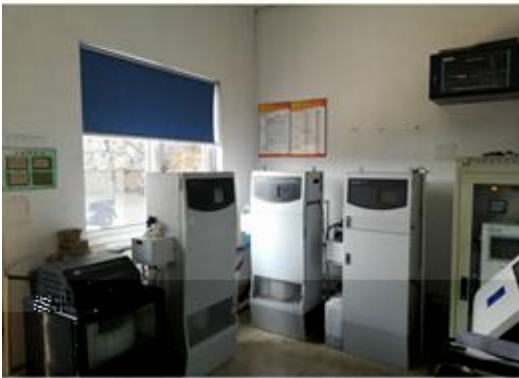
废水处理站南区废水在线监控设施
